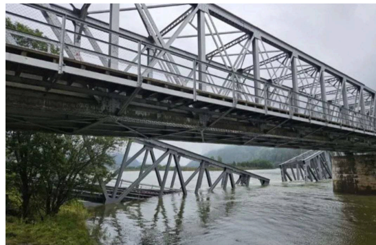
Randklev jernbanebru over Gudbrandsdalslågen i Ringebu ble hardt skadd under ekstremværet Hans.
